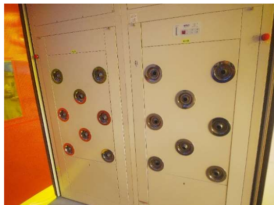
エアシャワー完備
